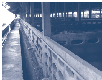
รางระบายน้ำเสีย
